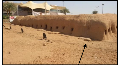
لوحة رقم ١٨ الجناح الشمالي لطابية الملازمين الجنوبية من الداخل، ويظهر فيه سد أحد فتحات المزاغل في الصيانة. تصوير الباحثة.
