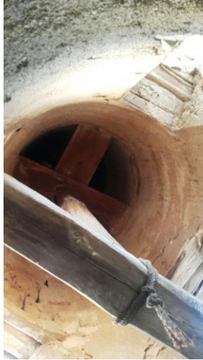
لوحة (٢٨-أ) مسجد الحنفي: تفاصيل للبراطيم الخشبية بالقسم العلوي للتجويف الداخلي للمئذنة (المستوى الثاني).
