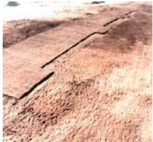
صورة (٣) توضح حفائر تل حبوة وظهور الرطوبة
